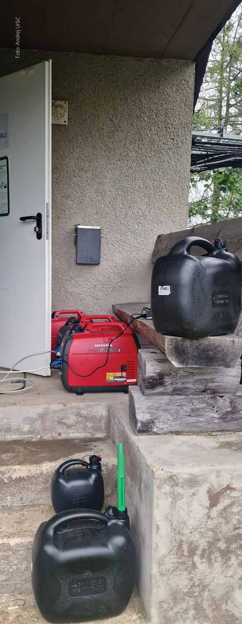
Agregati na objektu RTV Črna na Koroškem
